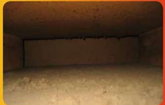
Blick in den verschmutzten Luftkanal einer RLT-Anlage. Deutlich zu sehen sind die Staub- und Schmutzablagerungen.
