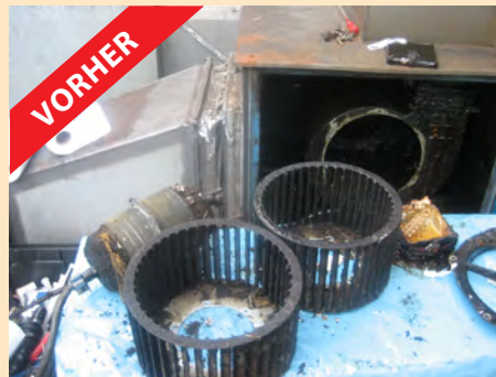
Der ehemals hochgradig verschmutzte Motor...
