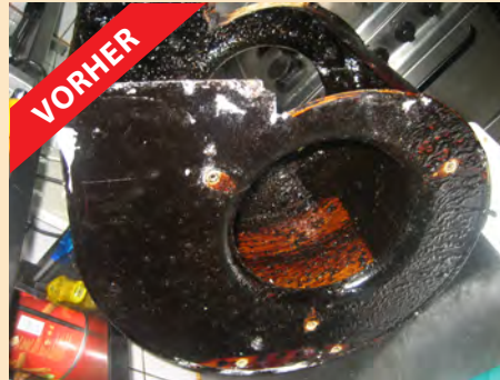
Das Lüftergehäuse in einem desolaten Zustand...
